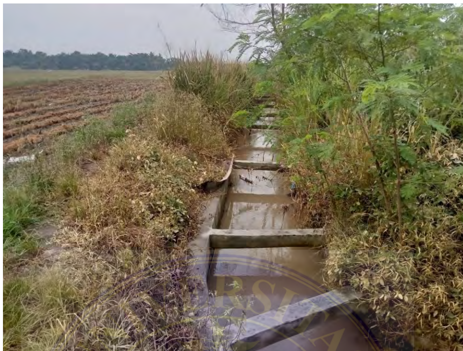
Gambar 3. Kondisi Jaringan Irigasi Sei Parit
