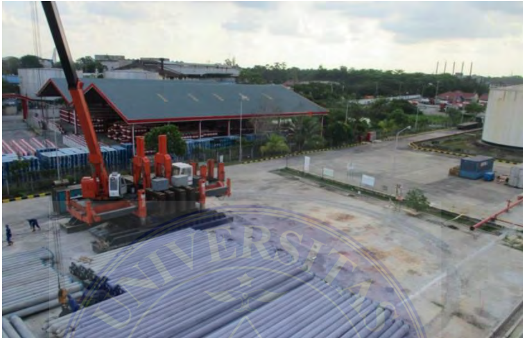
Gambar 1. Persiapan pemancangan pondasi dengan menggunakan Hydraulic Static Pile Drive yang sudah selesai dirakit
