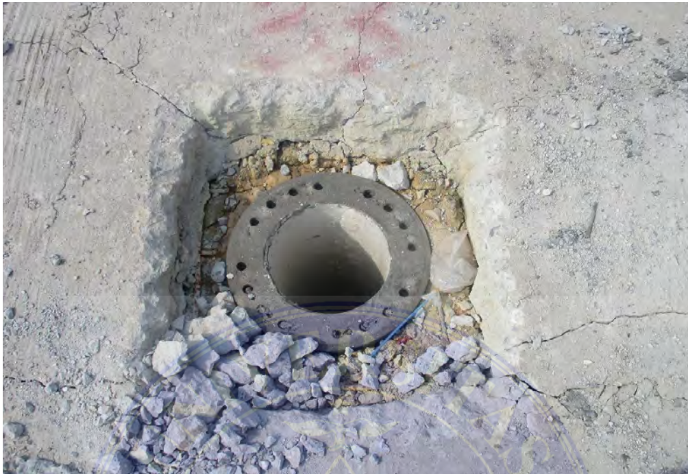
Gambar 6. Hasil pemancangan tiang pancang yang rata dengan permukaan tanah, secara kebetulan posisi kepala tiang selevel dengan permukaan elevasi rencana
