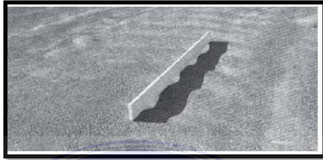
Gambar 6. Kerusakan Keriting (Bina Marga No 03/M.N/B/1983)
