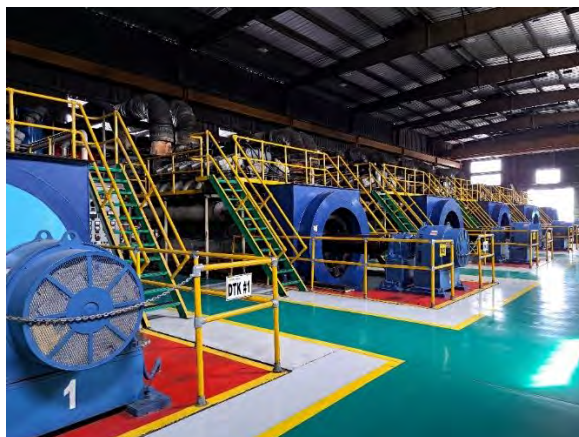
Gambar 3.5 Generator di PLTD titi kuning
