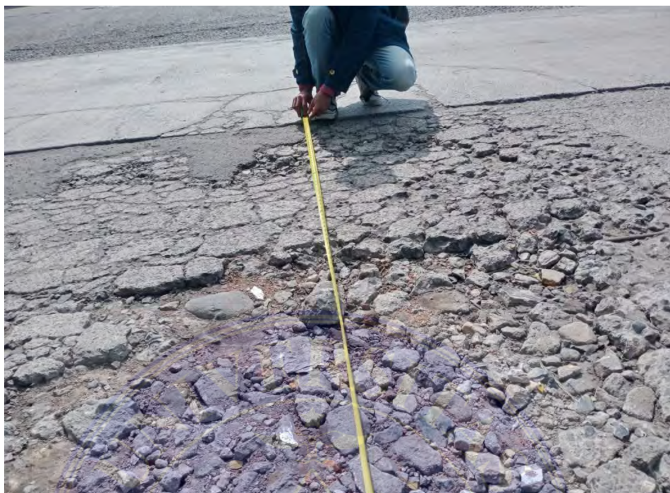
Foto Kerusakan di Jalan Mangan VIII Pasar III
