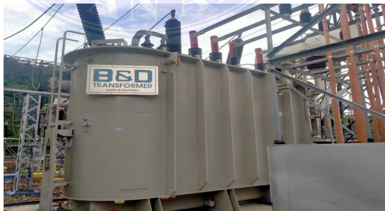
Gambar 2.1 Tranformator 3 Fasa (UPT Pematang Siantar)
