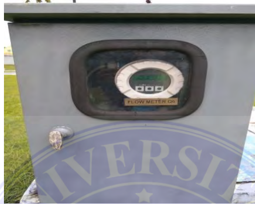
Gambar 3.3. Alat Ukur Flow Meter
