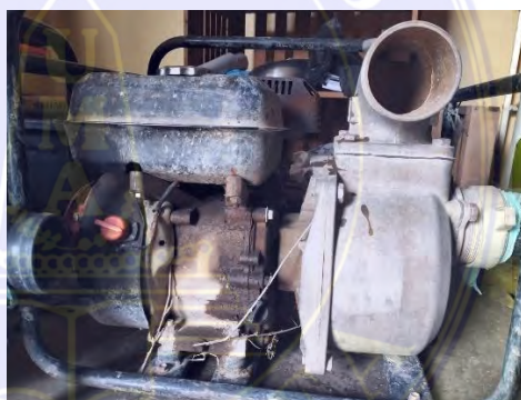
Gambar 9. Mesin Pompa Air
