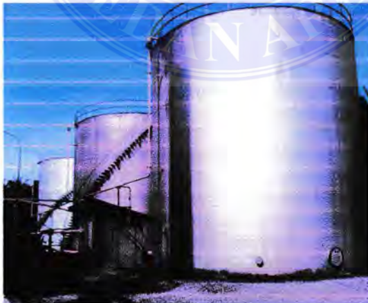
Gambar 2.10. Tangki Pengeringan Minyak ( Oil Storage Tank )
