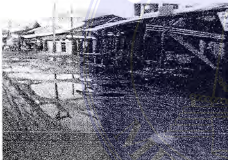
Kerusakan badan jalan
