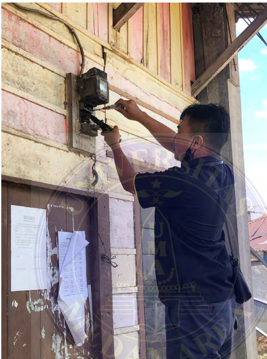
Gambar 3 Salah satu dari Tim P2TL saat melakukan pengecekan pada meteran Nasabah yang diduga melakukan pemakaian aliran listrik secara tidak sah di Desa Bunuraya
