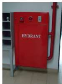
Hydrant Box yang berada dalam gedung Stadion Bung Karno
