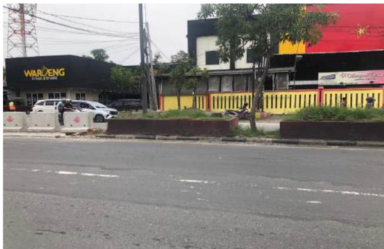
Gambar: Jenis Kerusakan Alur pada Jalan Asrama
