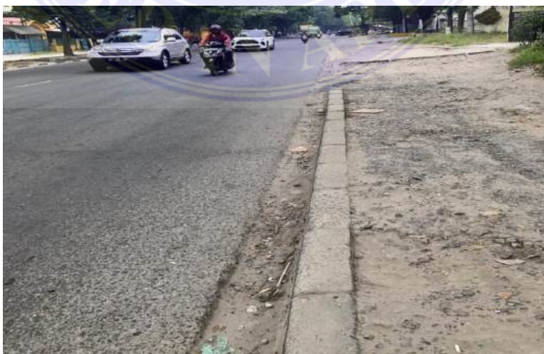
Gambar: Jenis Kerusakan Pinggiran Jalan Turun pada Jalan Asrama
