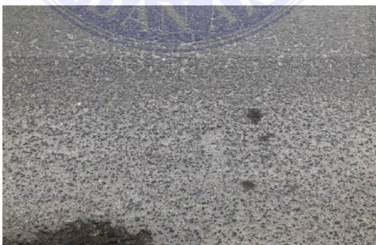
Gambar: Jenis Kerusakan Agregat Licin pada Jalan Asrama
