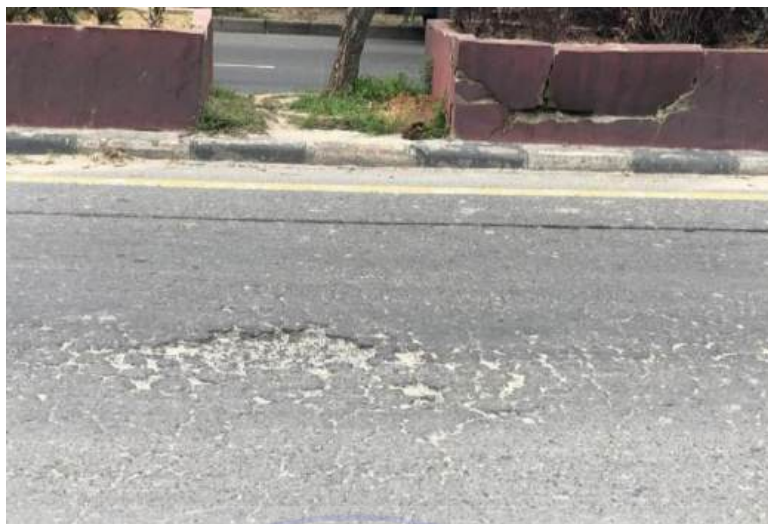
Gambar: Jenis kerusakan Retak Kulit Buaya pada Jalan Asrama
