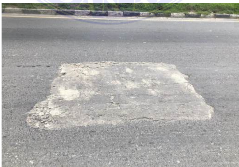
Gambar: Jenis Kerusakan Tambalan pada Jalan Asrama
