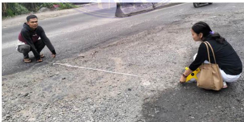
Gambar: Pengukuran Dimensi Kerusakan Lubang
