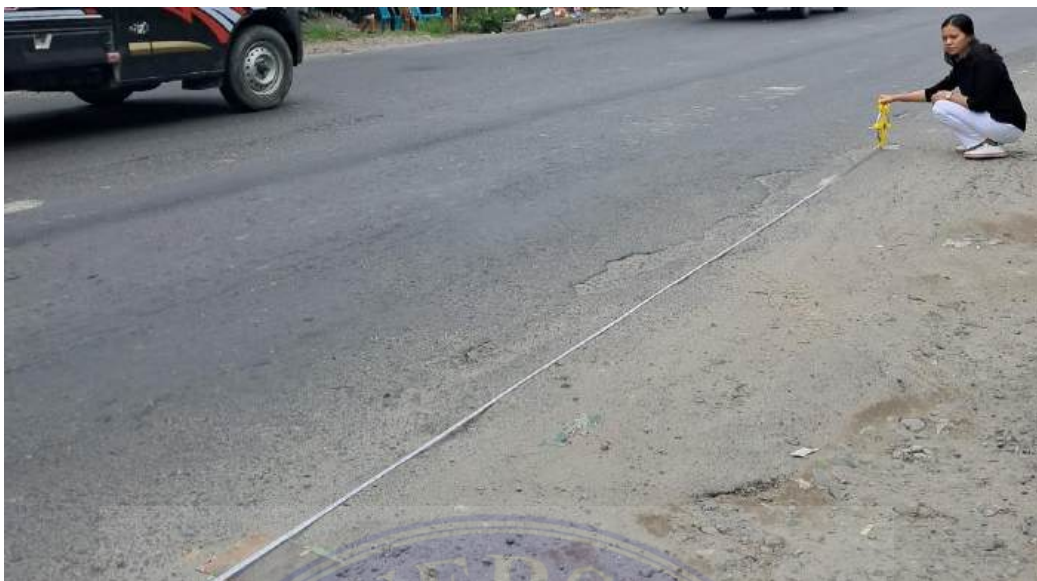
Gambar: Pengukuran Dimensi Jenis Kerusakan Retak pinggir
