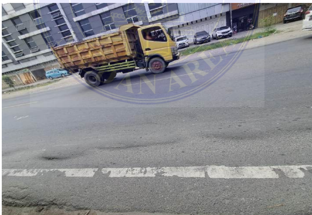
Gambar: Jenis Kerusakan Cekungan
