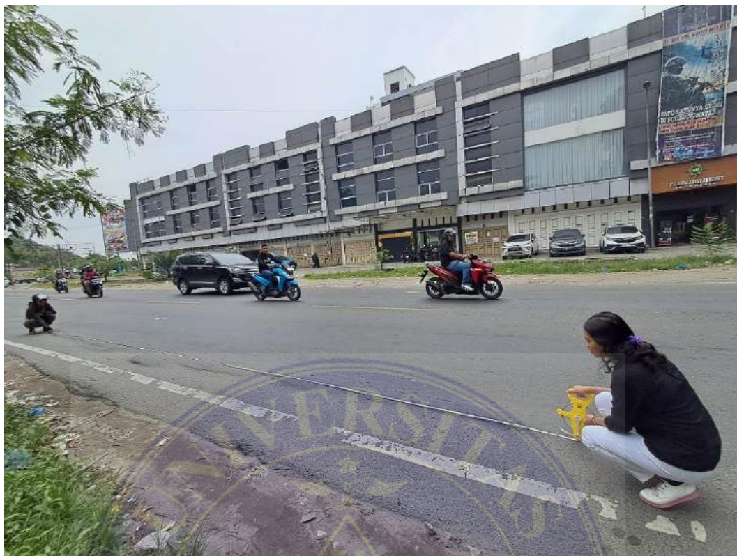
Gambar: Pengukuran Dimensi Kerusakan Cekungan
