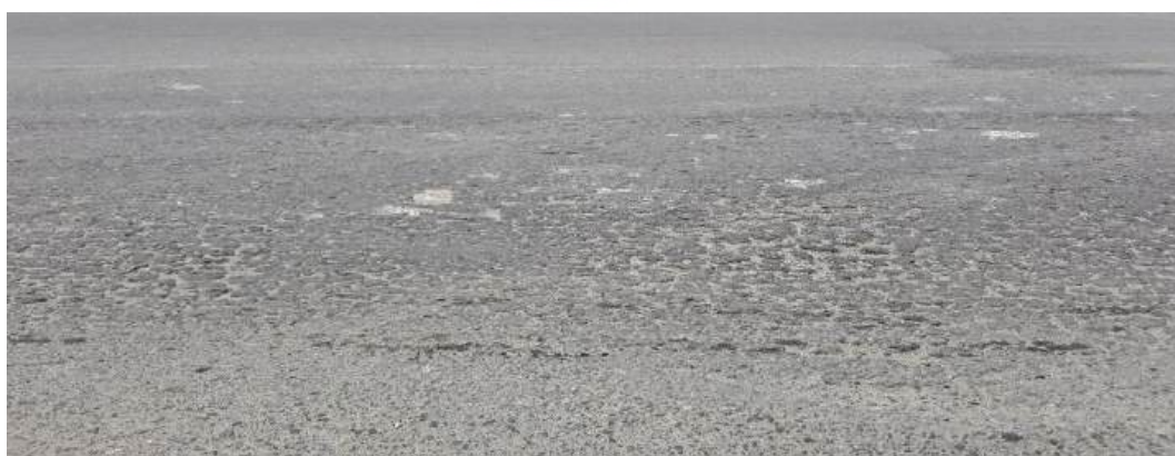
Gambar: Jenis Kerusakan Retak Buaya
