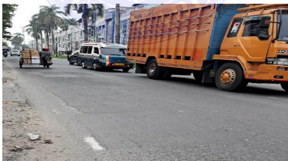
Gambar: Jenis Kerusakan Tambalan dan Galian Utilitas
