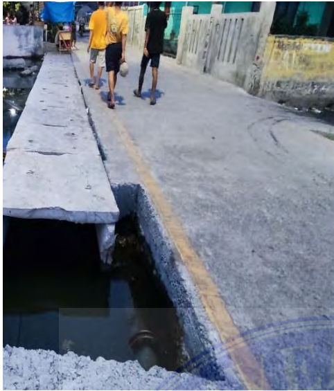
Kondisi Saluran Drainase Primer
