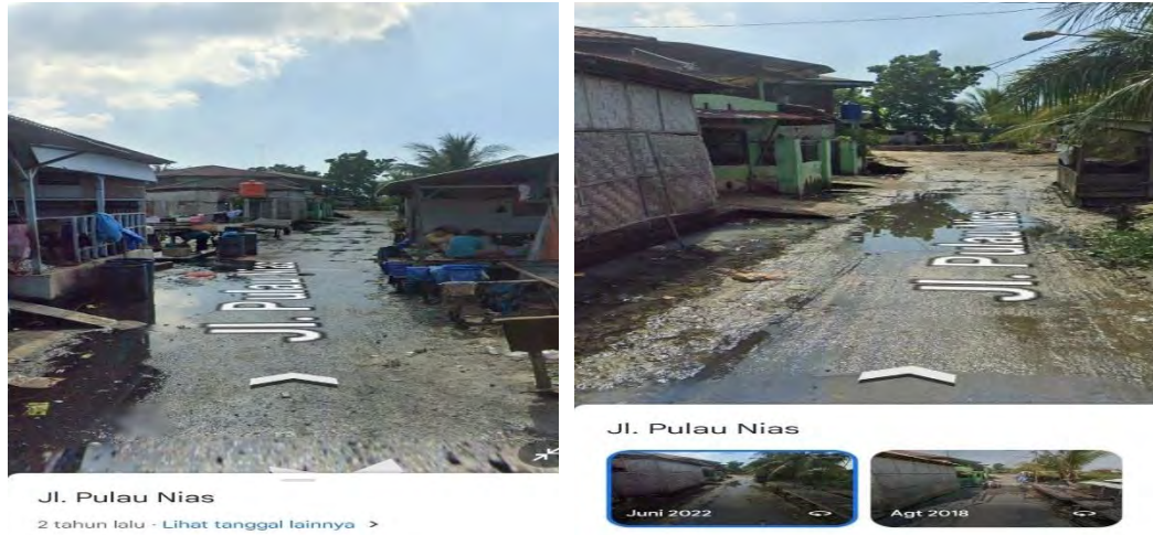
Gambar 16 Kondisi Saluran Drainase Sebelum Revitalisasi ( Google Earth , 2022)
