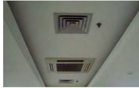
Gambar 34 Ac Sentral Dan Ventilasi
