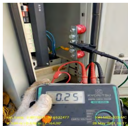
Gambar 3.12: Pemeriksaan rectifier yaitu memeriksa hidup atau mati dan apakah masih berfungsi normal. pengukuran grounding EGB-TG
