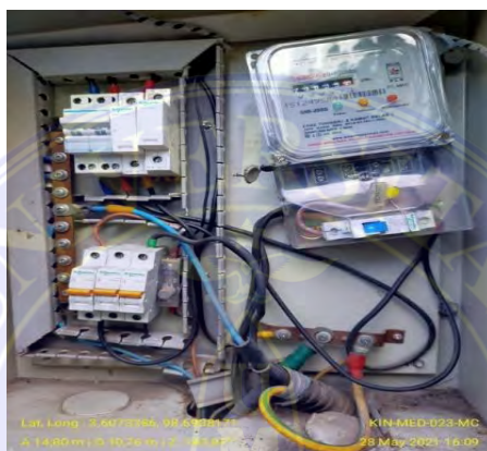
Gambar 3.14: Kondisi KWH panel (keadan terbuka) mengecek kabel instalasi tidak longgar dan box control pln dalam keadaan kotor kemungkinan ada serangga atau kotoran cicak
