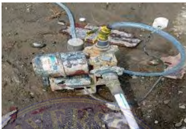
Gambar 3.1.30 Mesin Pompa Air Sumber : Data Lapangan
