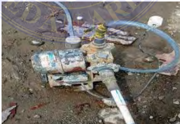
Gambar 3.1.31 Mesin Pompa Air Sumber : Data Lapangan
