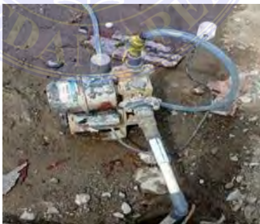
Gambar 3.31 Mesin Pompa Air Sumber : Data Lapangan
