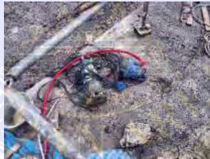
Gambar 3. 11 Pompa Air Sumber : Data Lapangan
