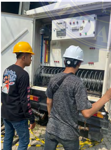
Trafo Back UP
