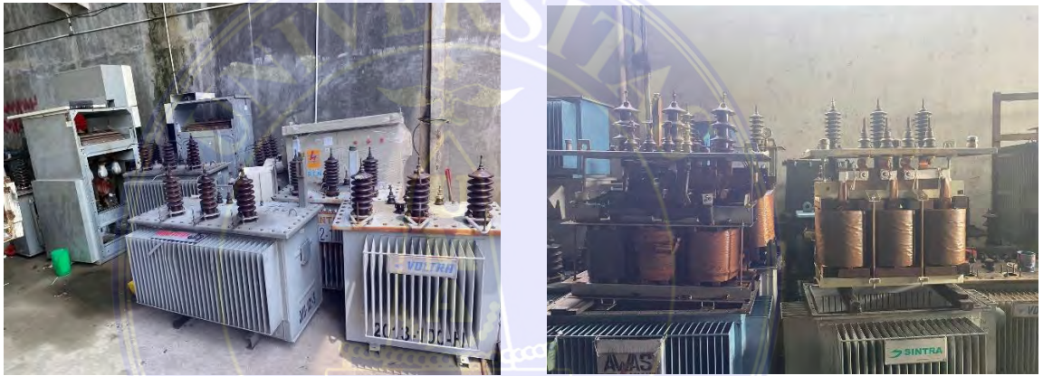
Gudang penyimpanan Trafo Distribusi DI PT. RAZZA PRIMA TRAF0.
