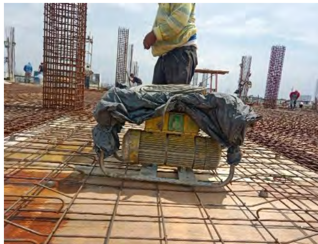
Gambar 3.4 Vibrator Sumber: Data Lapangan
