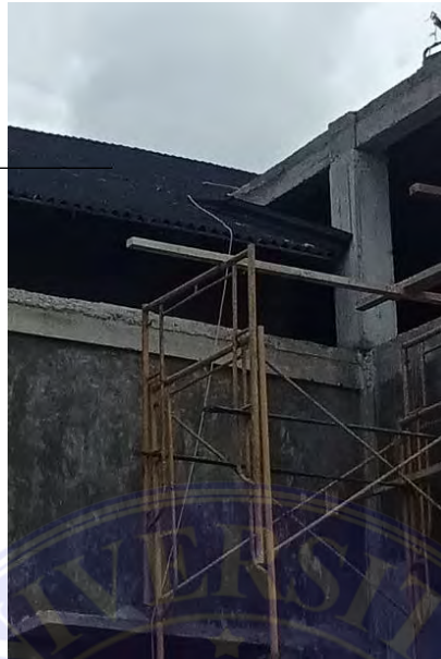
Gambar 31 : Material penutup atap Onduvilla pada BP2RD ( Dokumentasi Penulis, 2022)
