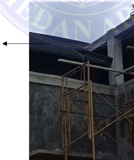
Gambar 47 : Material penutup atap Onduvilla pada BP2RD ( Dokumentasi Penulis, 2022)
