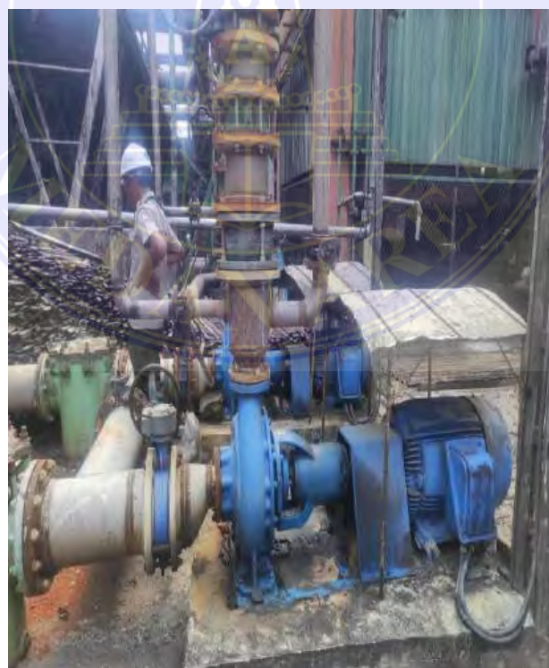
Lampiran 4. Pompa sentrifugal yang digunakan untuk memompa air pada cooling tower (menara pendingin)
