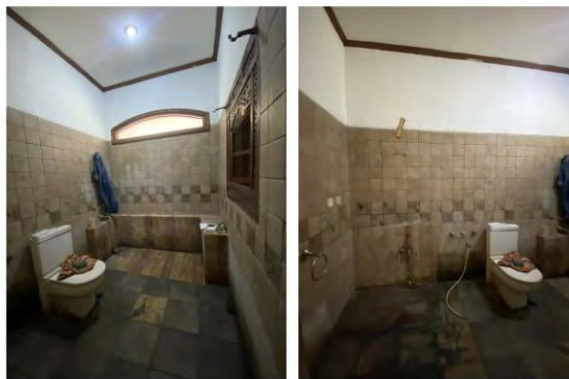
Gambar 2 15 Kondisi Awal Pada Toilet Cafe Barito
