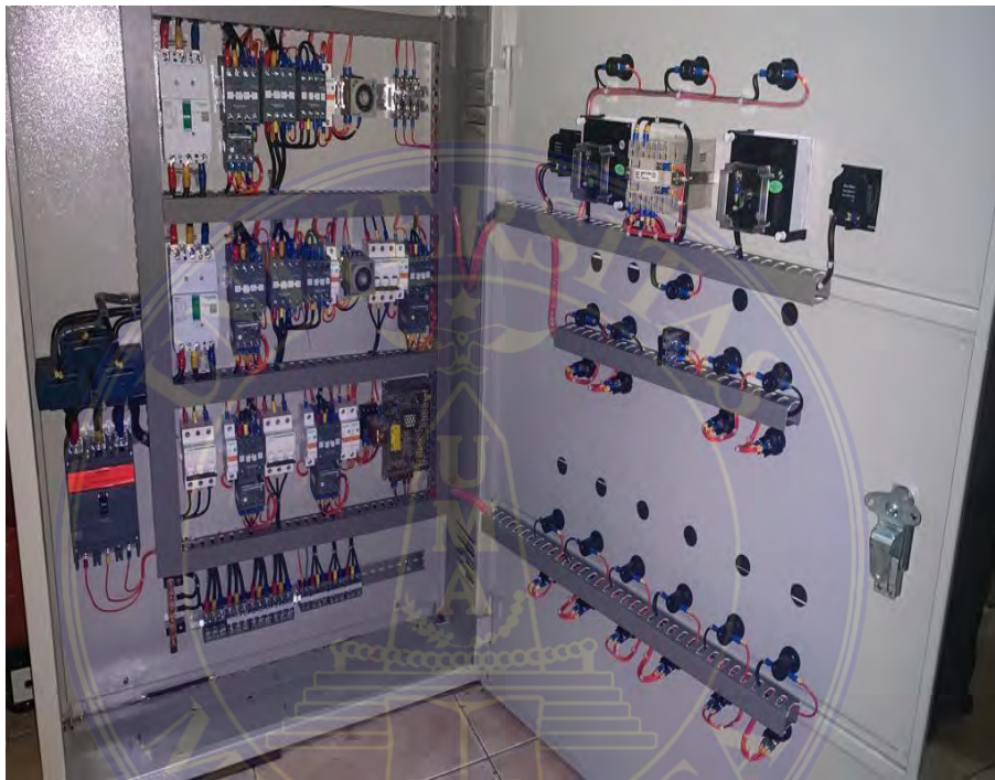
Gambar 1.1: Panel listrik star-delta (sumber:cv.Lidarpa Elektrik)
