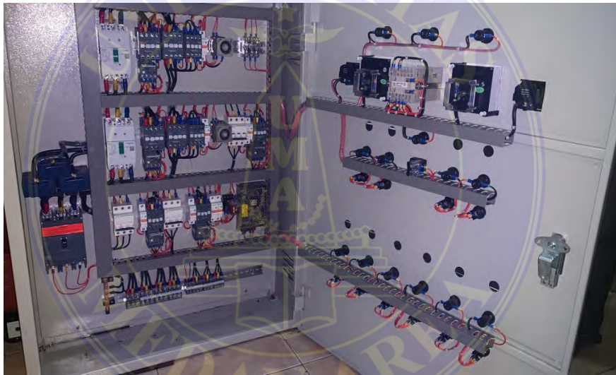
Gambar 4.1 hasil perakitan panel star delta (sumber:cv.Lidarpa Elektrik)
