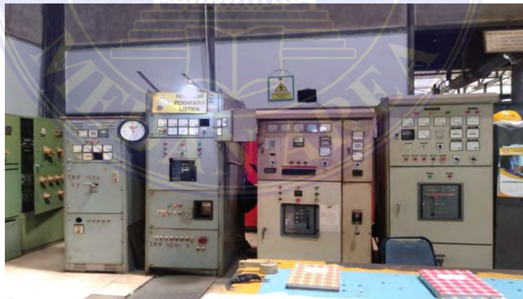
Gambar 3.29. Panel Tenaga Listrik ( PLN )
