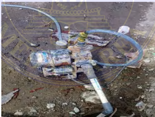
Gambar 3. 11 Pompa Air Sumber : Data Lapangan
