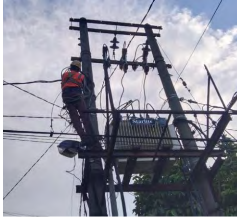
Gambar 2.13 Pemrosesan Penyambungan Fuse Cut Out
