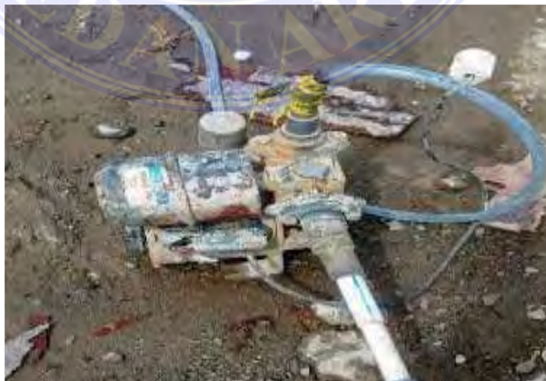
Gambar 3.1.31 Mesin Pompa Air
