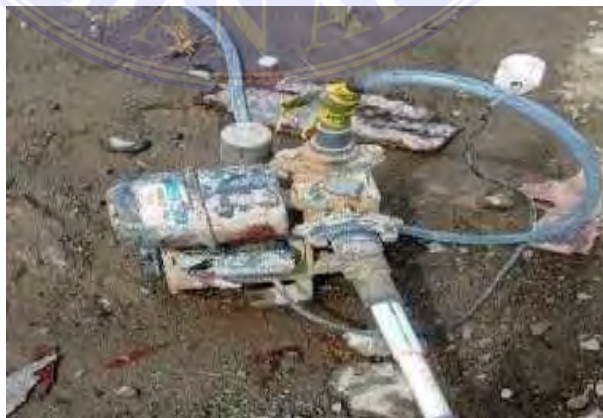
Gambar 3.1.31 Mesin Pompa Air Sumber : Dokumentasi Proyek
