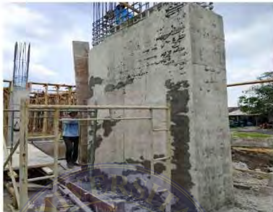
Gambar 4.9 Kerusakan Hasil Pengecoran
