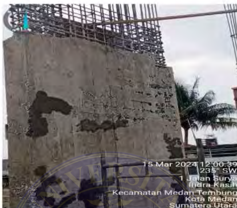
Gambar 4.8 Kerusakan Hasil Pengecoran
