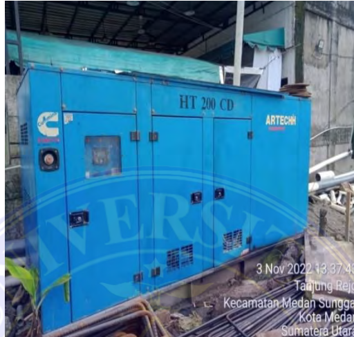
Gambar 3.1.18 Genset Sumber : Lampiran Lapangan
