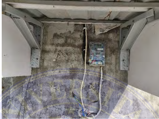
Gambar 3.1.16 Saklar Listrik Sumber : Lampiran Lapangan
