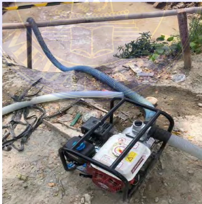
Gambar 3.15 Pompa Air Sumber : Data Lapangan
