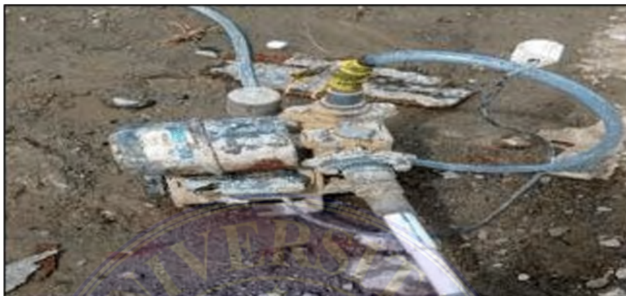
Gambar 3.31 Mesin Pompa Air Sumber : Dokumentasi Lapangan
