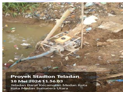
Gambar 3.1.6 Mesin pompa air (Dokumentasi Proyek)
