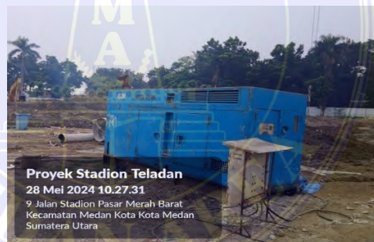
Gambar 3.1.13 Genset (Dokumentasi Proyek)
