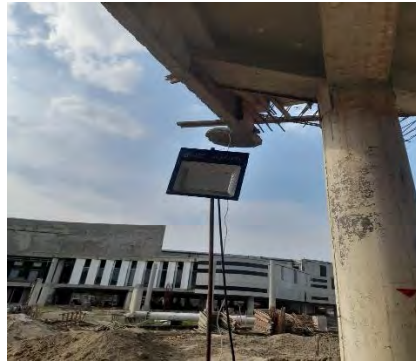
Gambar 3.29 Lampu Penerangan Sumber : Dokumentasi Proyek, 2024
