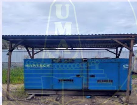
Gambar 3.32 Genset Sumber : Dokumentasi Proyek, 2024
