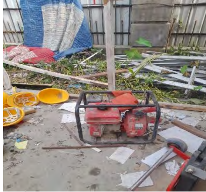
Gambar 3.17 Mesin Pompa Air Sumber : Dokumentasi Proyek, 2024
