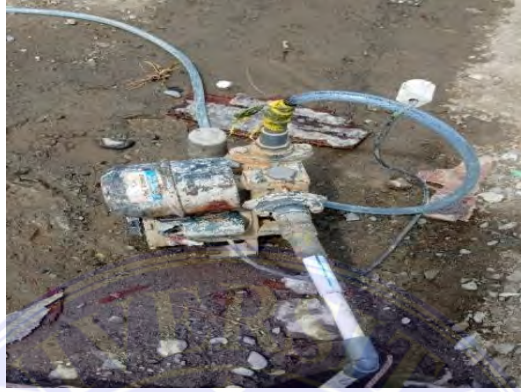
Gambar 3. 14 Pompa Air Sumber : Data Lapangan
