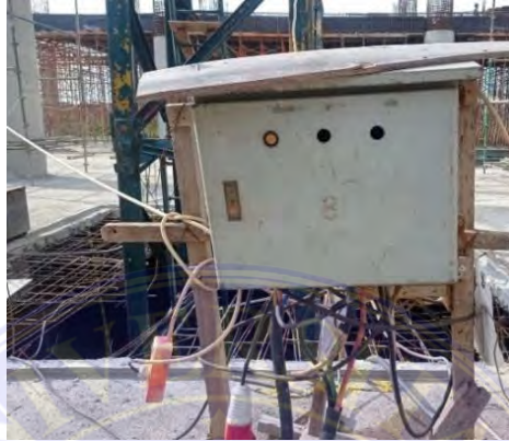
Gambar 3. 16 Saklar Listrik Sumber : Data Lapangan
