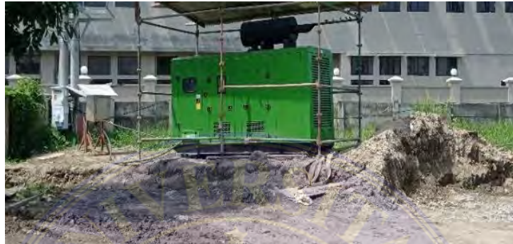
Gambar 3. 18 Genset Sumber : Data Lapangan
