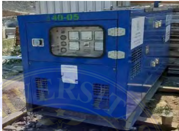
Gambar 3.6 Genset sumber : dokumentasi lapangan
