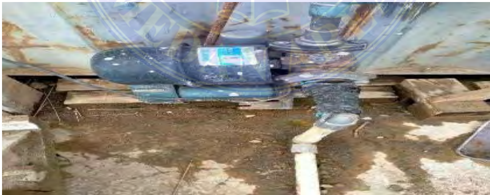
Gambar 3.9 Mesin Pompa Air , Sumber : Dokumentasi Proyek 2024
