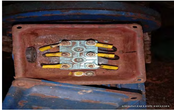
Pengecekan terminal motor induksi yang mati tiba-tiba
