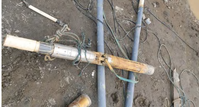
Gambar 3. 15 Pompa Air Sumber : Dokumentasi Lapangan
