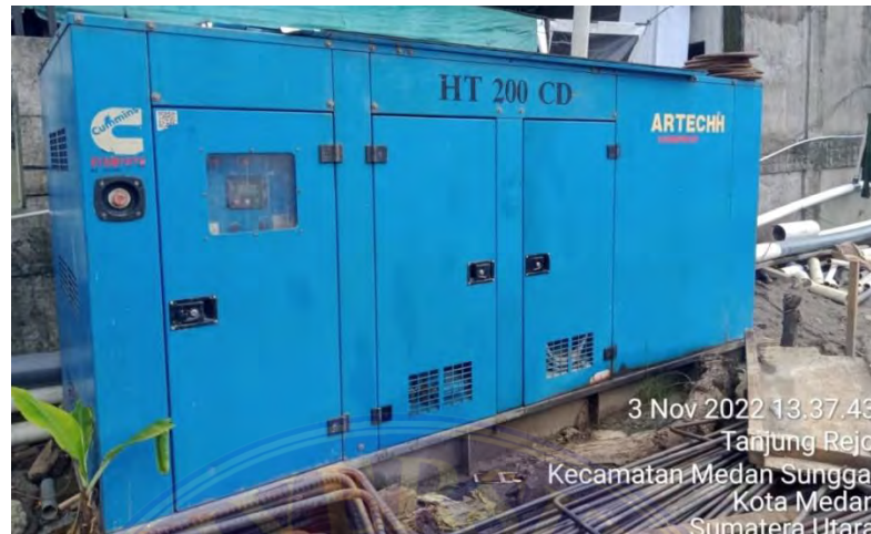
Gambar 3. 12Genset Sumber : Dokumentasi Lapangan
