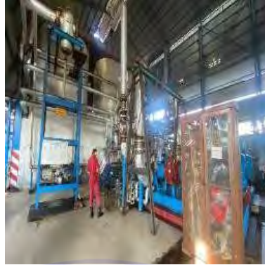
Gambar 3. 32 Stasiun Power House
