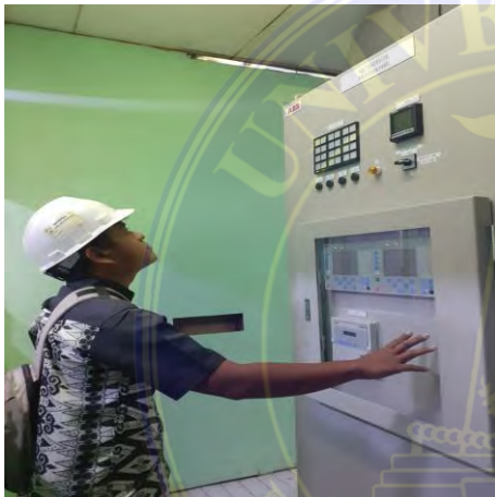
Kegiatan pengenalan panel protection generator
