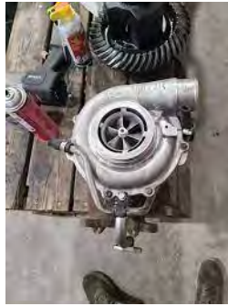
Gambar 4. 3 Turbocharger pada genset
