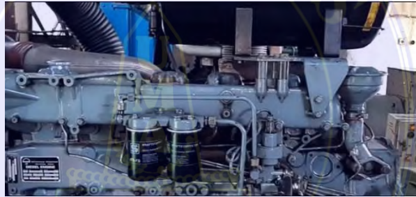
Gambar 3. 3 Mesin generator set 25 Kva
