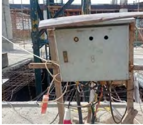
Gambar 3.16 Saklar Listrik Sumber : Data Lapangan
