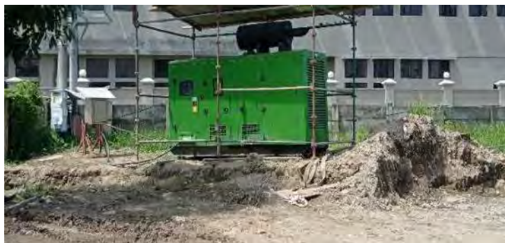
Gambar 3.18 Genset Sumber : Data Lapangan
