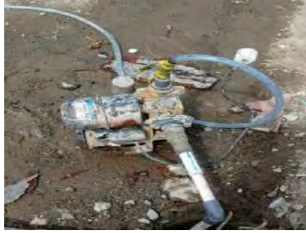
Gambar 3.14 Pompa Air Sumber : Data Lapangan
