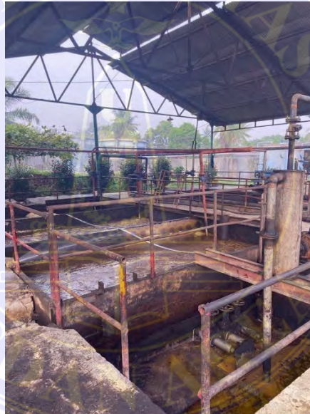
Gambar 3. 23 Bak Penampung Sludge (Fat Fit)
