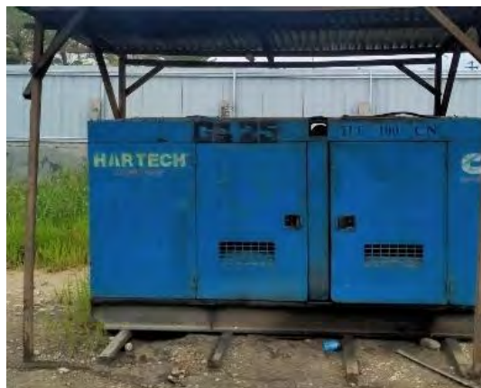
Gambar 2.10 Genset Sumber: Data Lapangan 2023
