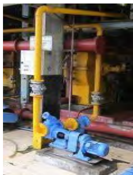
Gambar 39. Pompa Minyak Bersih
